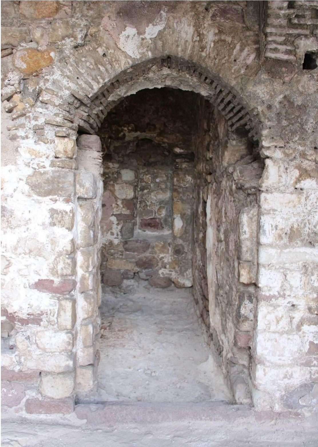
Εικ. Α22 Θύρα στον όροφο όπου διατηρείται μόνο το κατώφλι του λίθινου πλαισίου (οι παραστάδες και το τοξωτό ανώφλι έχουν αποσπαστεί). Εκατέρωθεν του κατωφλιού διακρίνονται εσοχές στην τοιχοποιία για την προσαρμογή των παραστάδων.
