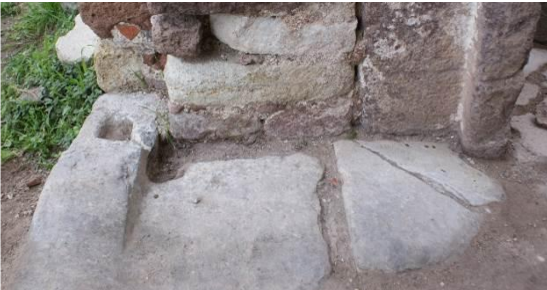
Εικ. Β9-Β10 Αυλόθυρα Οθωμανικού Ιεροδιδασκαλείου. Διατηρείται το κατώφλι από γκρίζο (κυανότεφρο) μάρμαρο που φέρει εντορμίες για την προσαρμογή των παραστάδων του πλαισίου, καθώς και οι εσοχές στην τοιχοποιία για την προσαρμογή των μαρμάρινων παραστάδων.
