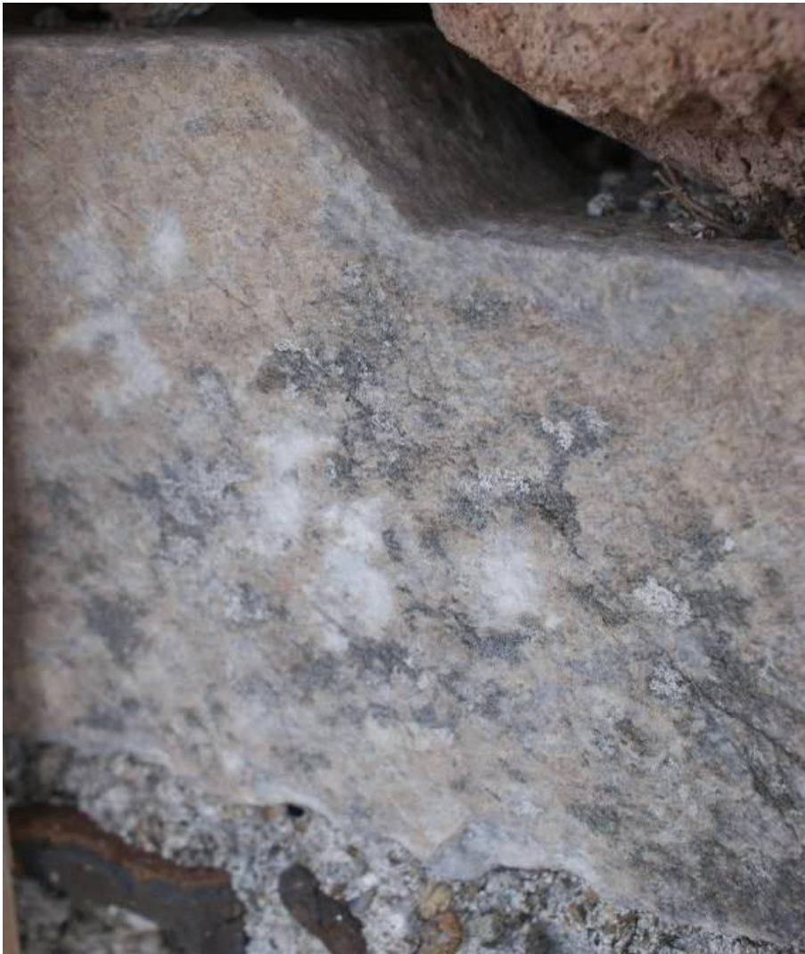
Εικ. Β17-Β18 Λεπτομέρειες ποδιάς πλαισίου παραθύρου από γκριζωπό μάρμαρο στον όροφο που σώζεται κατά χώραν (βορειοδυτική όψη του κτηρίου). Διακρίνονται οι λοξότμητες αποτιμήσεις για την προσαρμογή της δεξιάς παραστάδας του πλαισίου.
