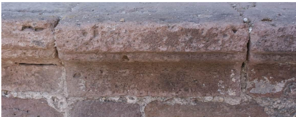
Εικ. Α7 Διατηρούμενο τμήμα του γείσου απλούστερης διατομής (χωρίς σπείρα) από την επίστεψη της στοάς στο ισόγειο.
