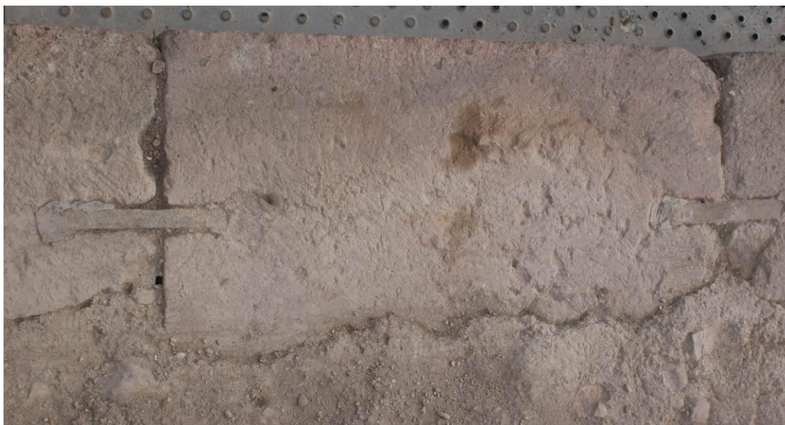
Εικ. Α10 Τμήμα του γείσου επίστεψης της στοάς στον όροφο (άνω όψη). Τα επιμέρους μέλη συνδέονται με πειόσχημους σιδηρούς συνδέσμους που διατηρούνται σε κακή κατάσταση σε όλη την έκταση του γείσου στο επίπεδο αυτό.
